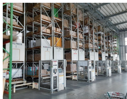
■ 自動立体倉庫
