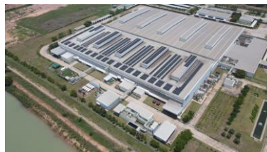
屋根設置型 太陽光発電所
