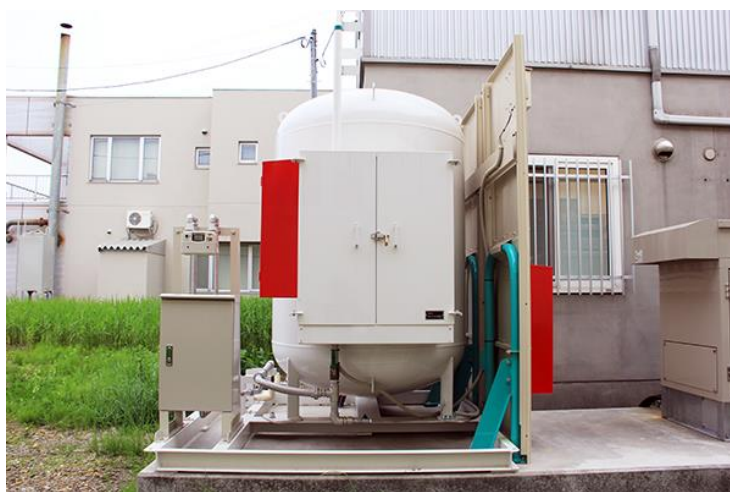
LP ガス貯槽（写真：同社提供）
