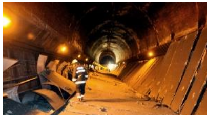
中央高速道 笹子トンネル事故(2012/1/2) 死者9名 写真: 山梨県大月市消防本部許可
