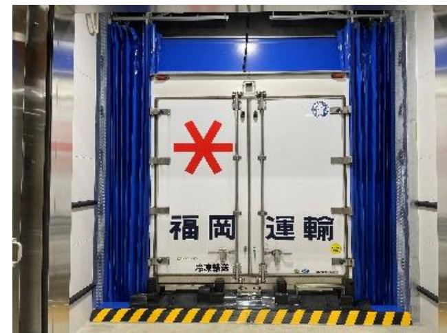
ドックシェルター 気密装置設置バース
