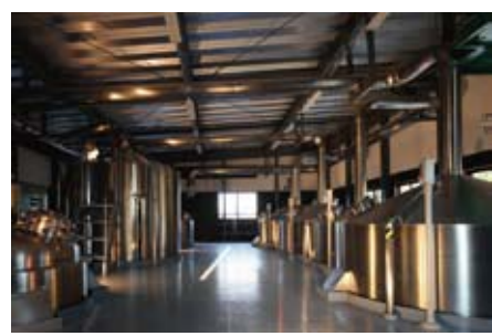
額田ビール工場の発酵・濾過設備
