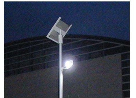
点灯している「LED防災防犯灯」
