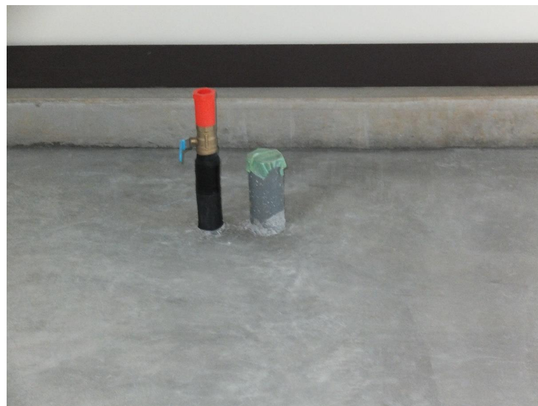
(左)⇒給水口(バルブ止め)、(右)⇒排水口(キャップ止め)
