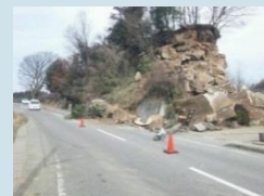
須賀川市の被害現場
