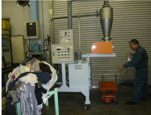
写真② 粉碎機全景（手前は回収衣料）
