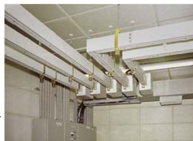
バスダクト施工例
