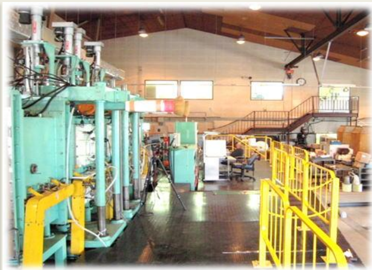
(写真) 新工場内の移設後の新規事業設備(左側)。特許を取得しており、量産型設備としては世界で唯一。
