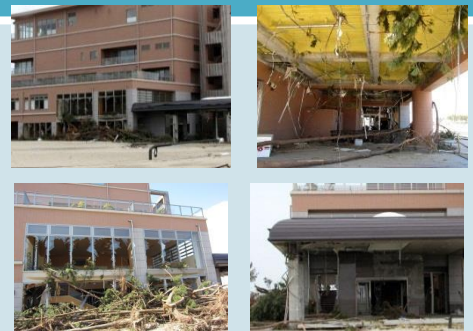
施設の被災状況
