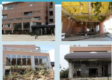
施設の被災状況
