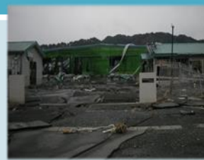
大槌施設の被災状況
