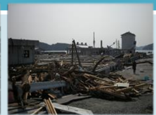
大船渡本所の被災状況
